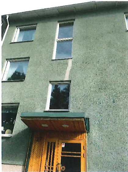
På bilden syns en genomgående spricka i trapphus
