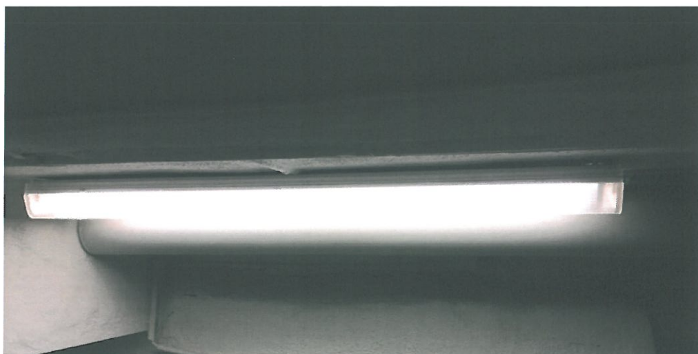
Figur 11. Belysning på källare med timerstyrning.
