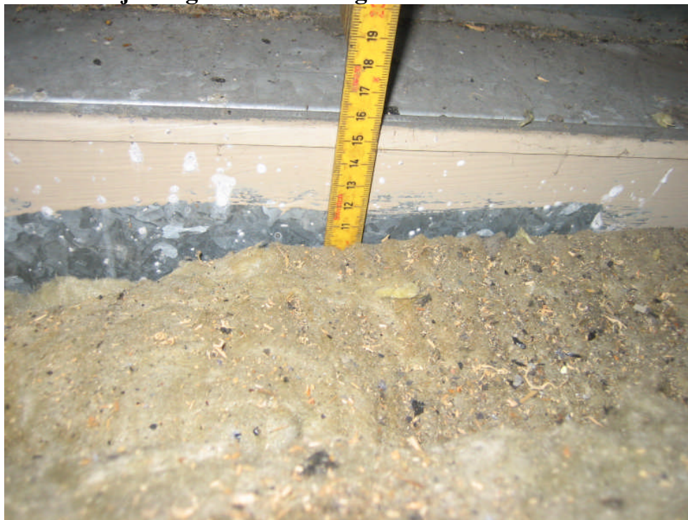
Bild på den befintliga isoleringen ca 10 – 12 cm.
