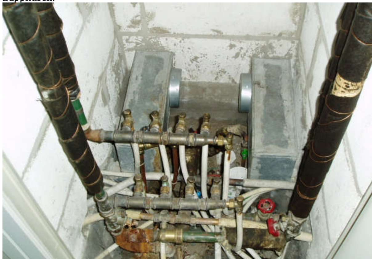
Kopplingsutrymme i trapphuset. Inkommande värme, vatten, varmvatten och varmvatten cirkulation.
