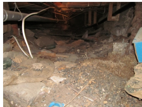
Mycket byggspill i krypgrund Wallingatan 6
