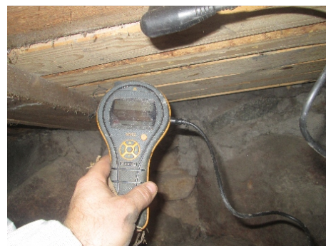
Förhöjd fuktkvot trossbotten. Smålandsgatan 19
